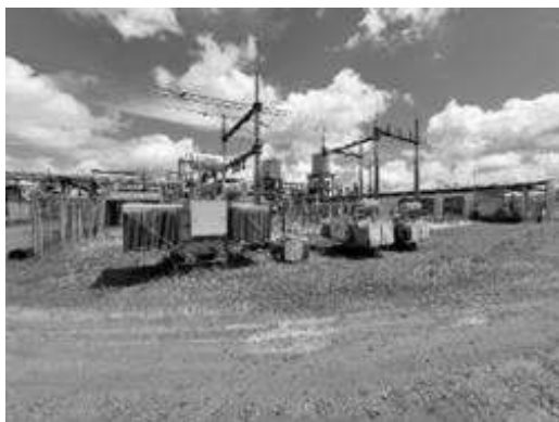
Figura 62 - Subestação elétrica principal (2)
