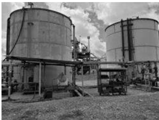
Figura 57 - Conjunto de 2 Tanque de água de processo
