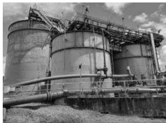
Figura 35 - Conjunto de dois tanques DETOX
