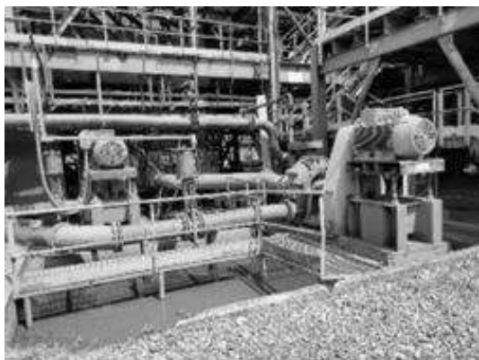
Figura 15 - Bomba UF Moagem WEIR MINERALS
