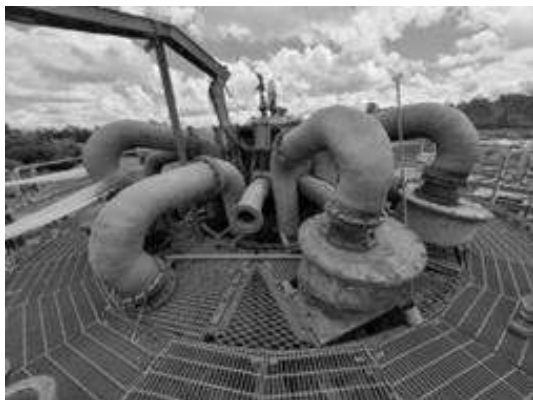
Figura 13 - Bateria de ciclones composta por 10 ciclones
