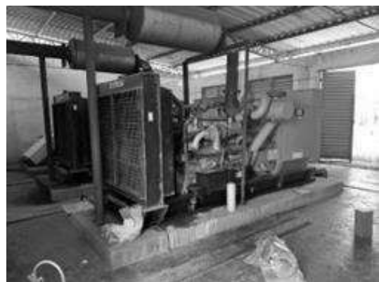
Figura 60 - Conjunto com 2 de Grupo Geradores de energia
