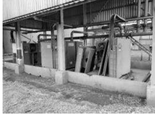
Figura 53 - Conjunto de Compressores de ar CHICAGO
