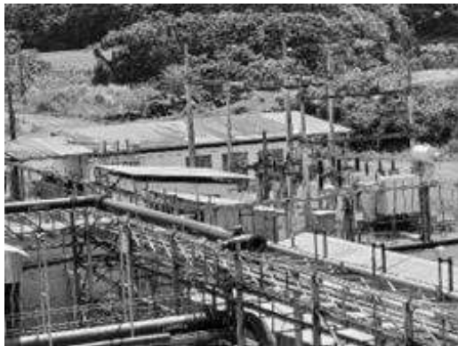
Figura 61 - Subestação elétrica principal (1)
