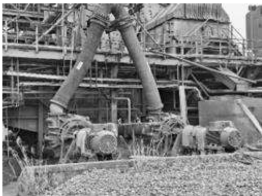
Figura 14 - Bombas de descarga para moagem WEIR MINERALS
