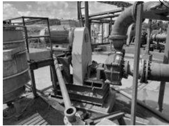
Figura 37 - Conjunto de 3 bombas WEIR MINERALS (2)
