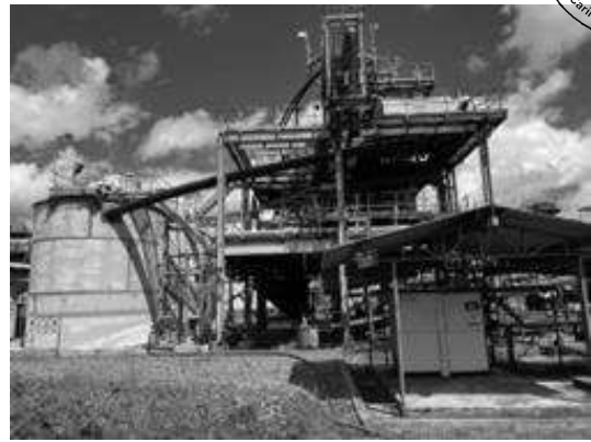
Figura 58 - Conjunto de 2 tanques de cal
